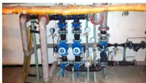
Фото 2 . ІТП "Укрінтерм" Модульний блок системи ГВП.
