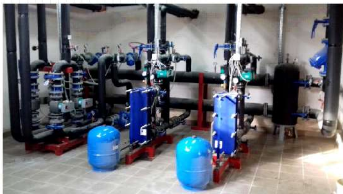
1. Тепловий пункт потужністю 1мВт, для потреб опалення та гарячого водопостачання житлового будинку по вул. В. Чорновола, 67 в м. Львові.
