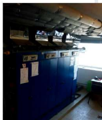
2. Дахова котельня потужністю 1,32 мВт, для потреб теплопостачання офісного центру ІТ-компанії по вул. Садовій, 2а в м. Львові.
