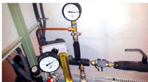
Фото 1 . ІТП "Укрінтерм" Модульний блок системи опалення
